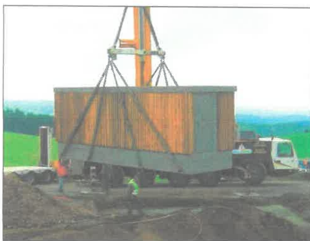
Figure 25 : Exemple de livraison d'un poste de transformation
